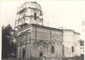
1. Vedere dinspre sud-vest in timpul restaurării, după dărâmarea prid- vorului adăugat în fața ușii dinspre sud.
